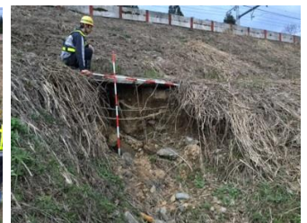
写真 - 2 盛土の沈下
