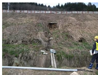
写真 - 1 変状全景
