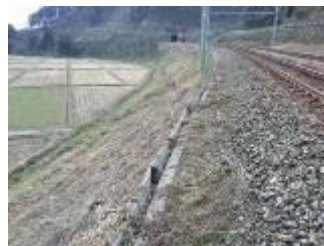
写真 - 3 バラスト止めの傾斜・沈下
