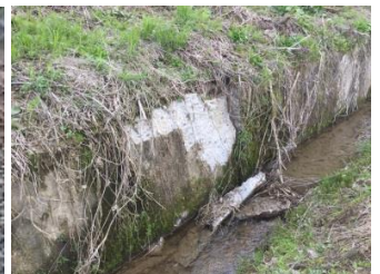
写真 - 4 土留壁のき裂・破損
