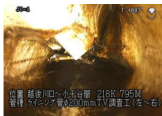
写真-8 破損箇所③
