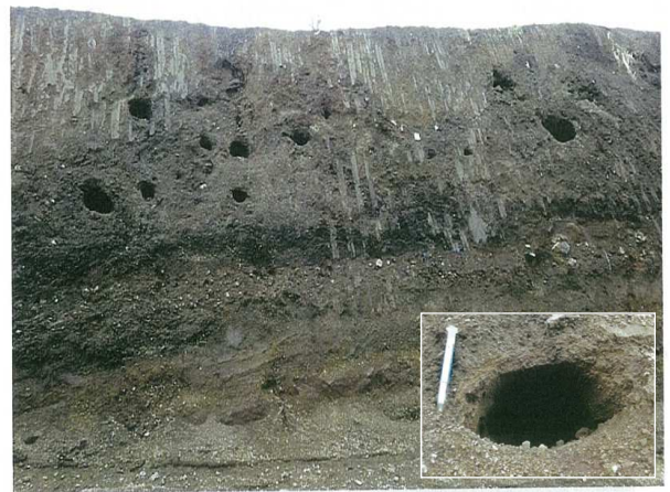
図-2 現場で遭遇した空洞
