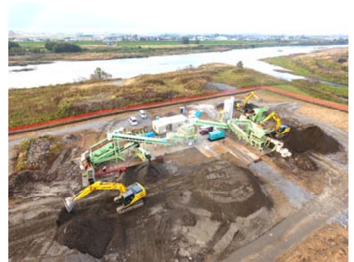
写真-1 土砂改良プラント全景
