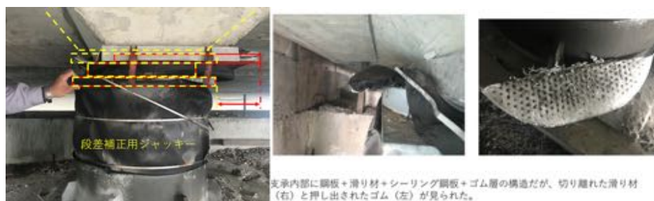
図-2 七星潭大橋の支承(2 方向 BP)の被害状況
