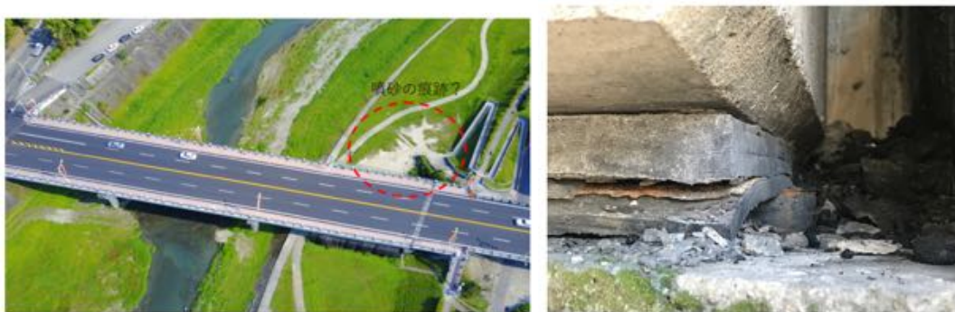
図-4 UAV 撮影により確認された尚志橋における噴砂の痕跡と支承の破壊
