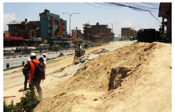
図 2 発生した亀裂に伴う 2m の段差
