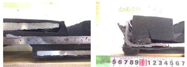
(a) 天板芯金の腐食
