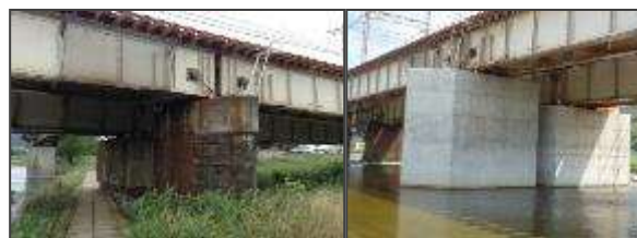
図1 対象橋脚概観 (左図:対策前, 右図:対策後)。
