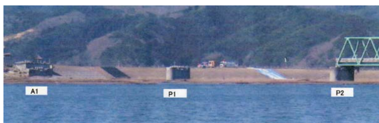
図-2 トラス橋の新北上大橋の流失した連続トラス部分
