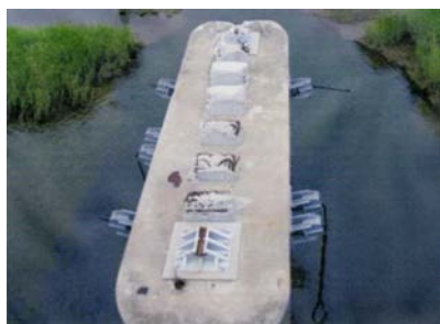
図-4 流失後のP1橋脚
