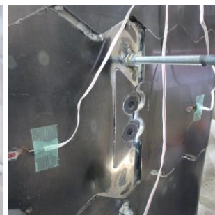
写真－３ 破断の状況
