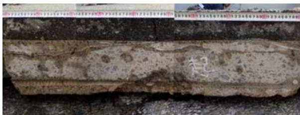
図-1 RC 床版内部水平ひび割れ的事例
