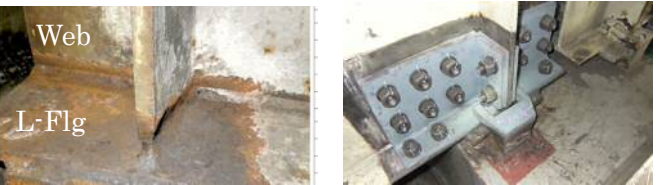
図-1 桁端部付近の腐食
