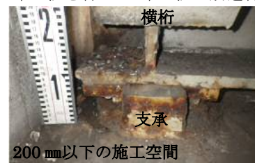
図-11 現場状況(狭隘)
