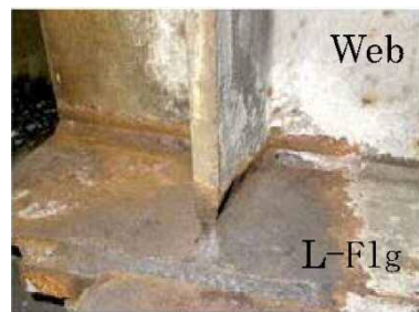
図-1 鋼桁端部の腐食損傷
