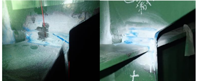
図-9. a 施工前き裂確認
