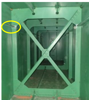
図-1 き裂発生箇所
