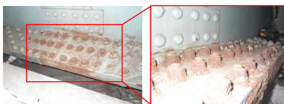
図-1 連結板の腐食例
