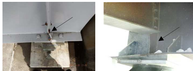
写真1 鋼橋主桁支点部の地震被害の例
