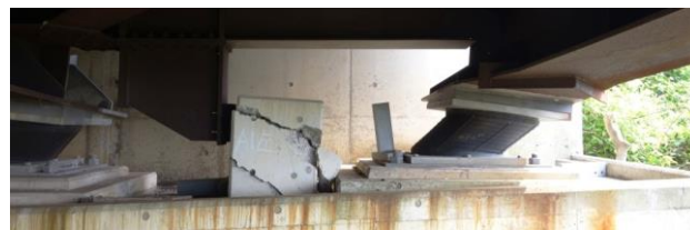
写真-1 変位制限構造の損傷状況
