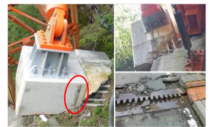
図-2 南阿蘇橋被災状況
