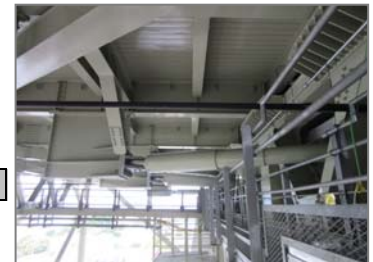
写真-1 床組制震ダンパー
