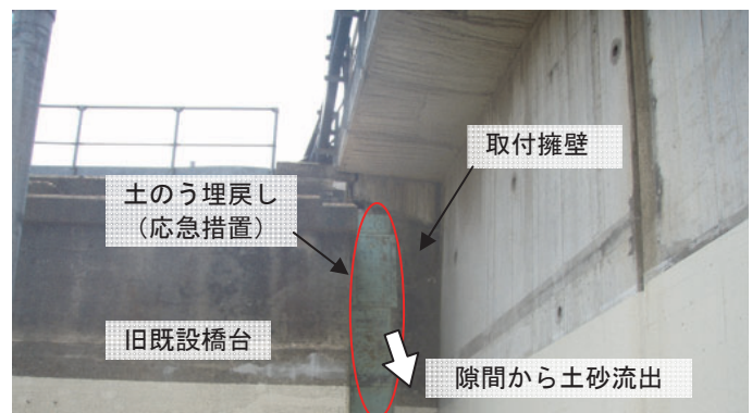
図-4 変状箇所②(山手線内回り側擁壁)池袋方より
