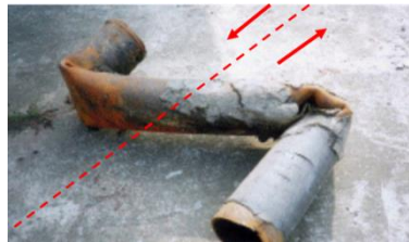
写真 1 断層変位による被害 1)
