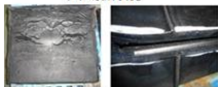
(B) 破断面 (C) ひび割れ部
