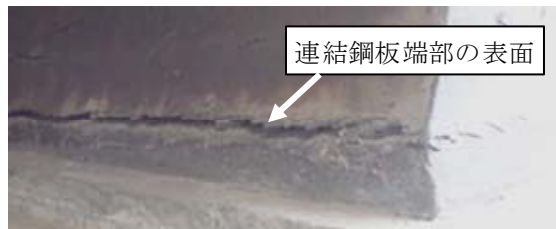
図1 実際の支承におけるオゾンクラック発生状況
