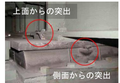
写真-1 LRB の変状
