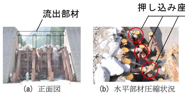
写真-1 梨子沢第1砂防堰堤被災状況
