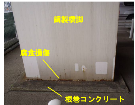
写真-1 鋼製橋脚の腐食状況
