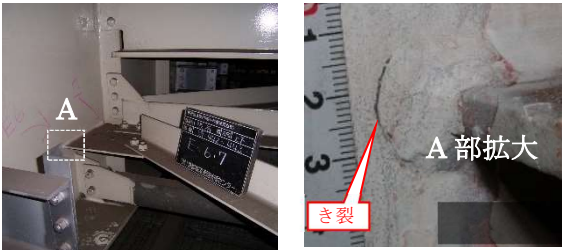
写真-1 ガセットの止端部のき裂
