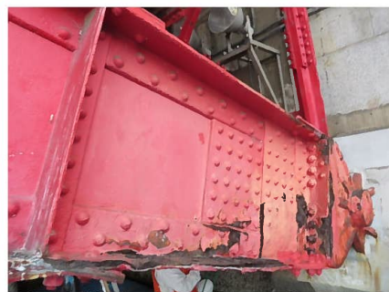
写真－2 鋼材腐食状況
