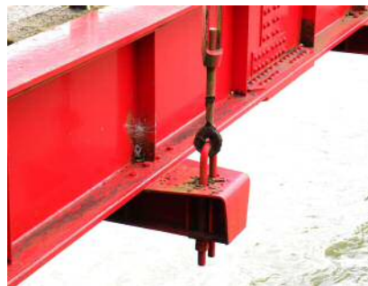
写真-2 張力抜けロッド腐食状況
