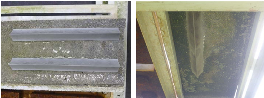
写真. 亜熱帯実環境にて 14 年暴露後の後付け型水切り部材の外観
