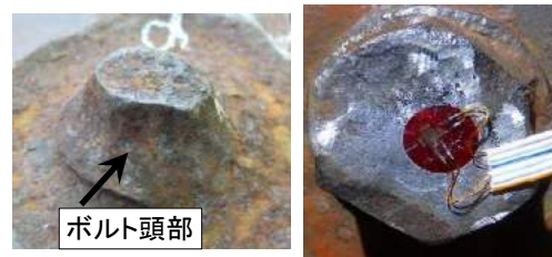
写真1 ボルト頭部の減肉例とひずみゲージ法
