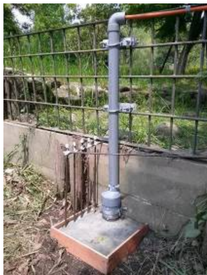
図-3 内水氾濫監視システム (沢渡川 センサ部分)
