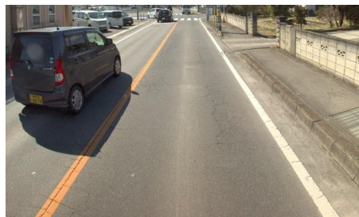
図1 日陰部分のひびが見えない
