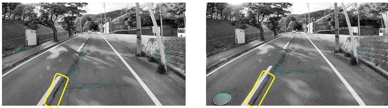
図2 太い舗装ひび割れ（幅4～5 c m）
