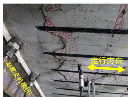
写真-3 破壊状況（軸方向端部）
