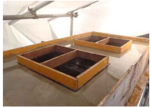
写真－2 排水桝の漏水状況
