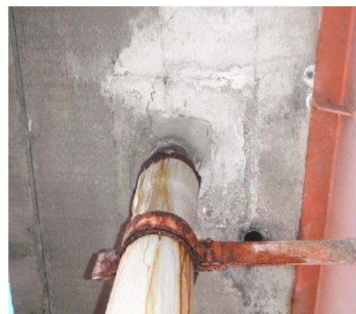
写真-1 排水桝の漏水状況
