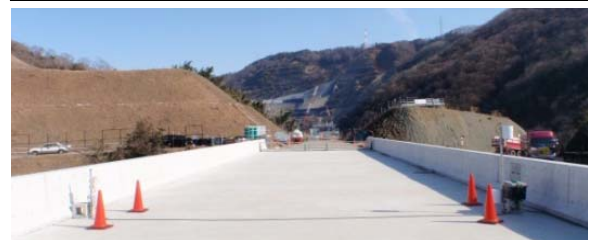
写真-3 計測機器設置状況
