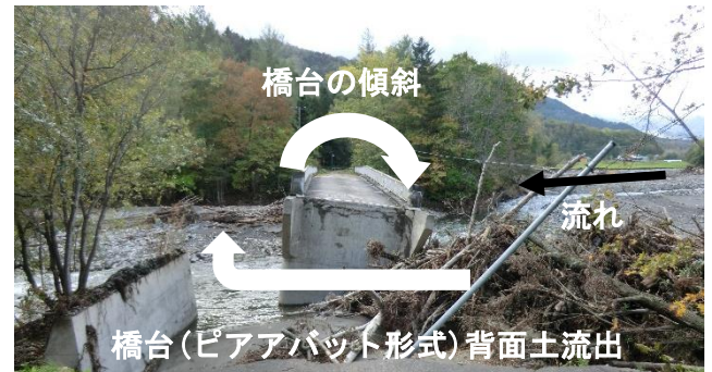
図-4 湯の沢橋の被災状況(左岸から撮影)
