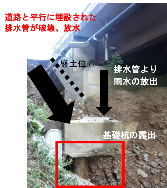
図-6 白花橋の被災状況(左岸上流側)
