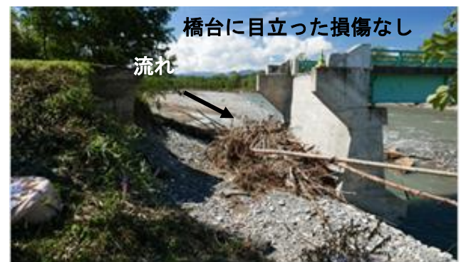
図-5 中島橋の被災状況(右岸橋台)
