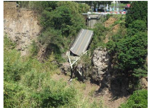
図-1 旧阿蘇大橋落橋状況
