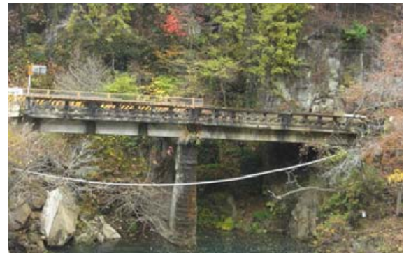
写真-1 朽ちていく橋
