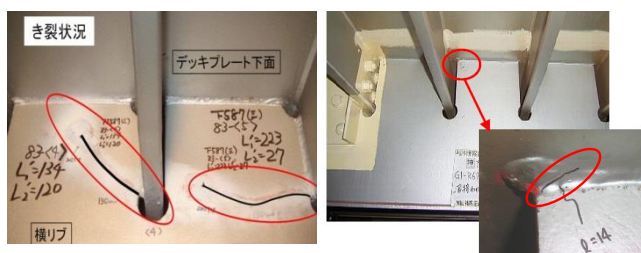
(a)縦リブと横リブの溶接止端部からき裂 (b)横リブとデッキプレート溶接部のき裂
