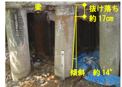
写真 2 パイルベント基礎損傷状況
