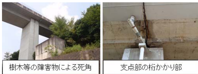
写真1 非破壊機器点検の死角範囲
