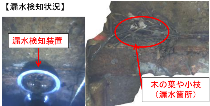
写真-4 漏水検知状況・漏水箇所の 3D 画像
