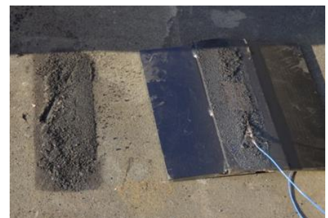
写真 2. アスファルトモルタル損傷状況
