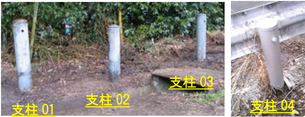
図 2 施工不良模擬供試体 外観
