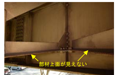
写真-2 昇降高さ不足
