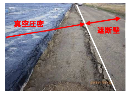
写真-2 遮断壁脇の引込み沈下状況
