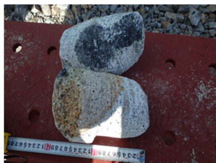
写真-1 防潮堤下部の転石の状況
