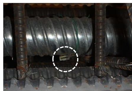
写真-4 POF センサー設置状況
