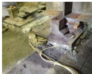
写真-1 支承部の放電破碎
